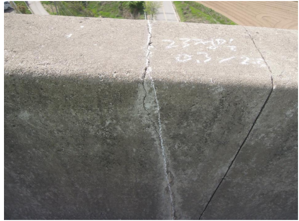
S7 방호벽 균열(0.3mm/2.5m)
