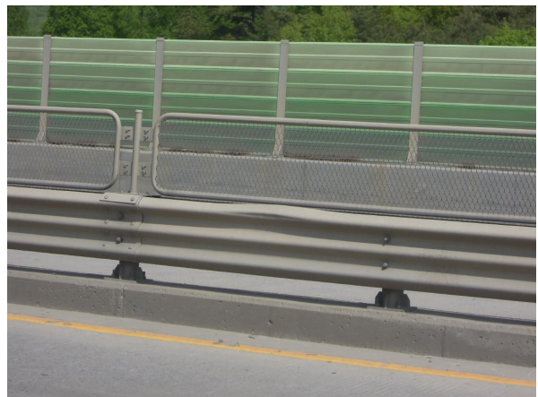
S10 중앙분리대 가드레일 변형(L=0.7m)
