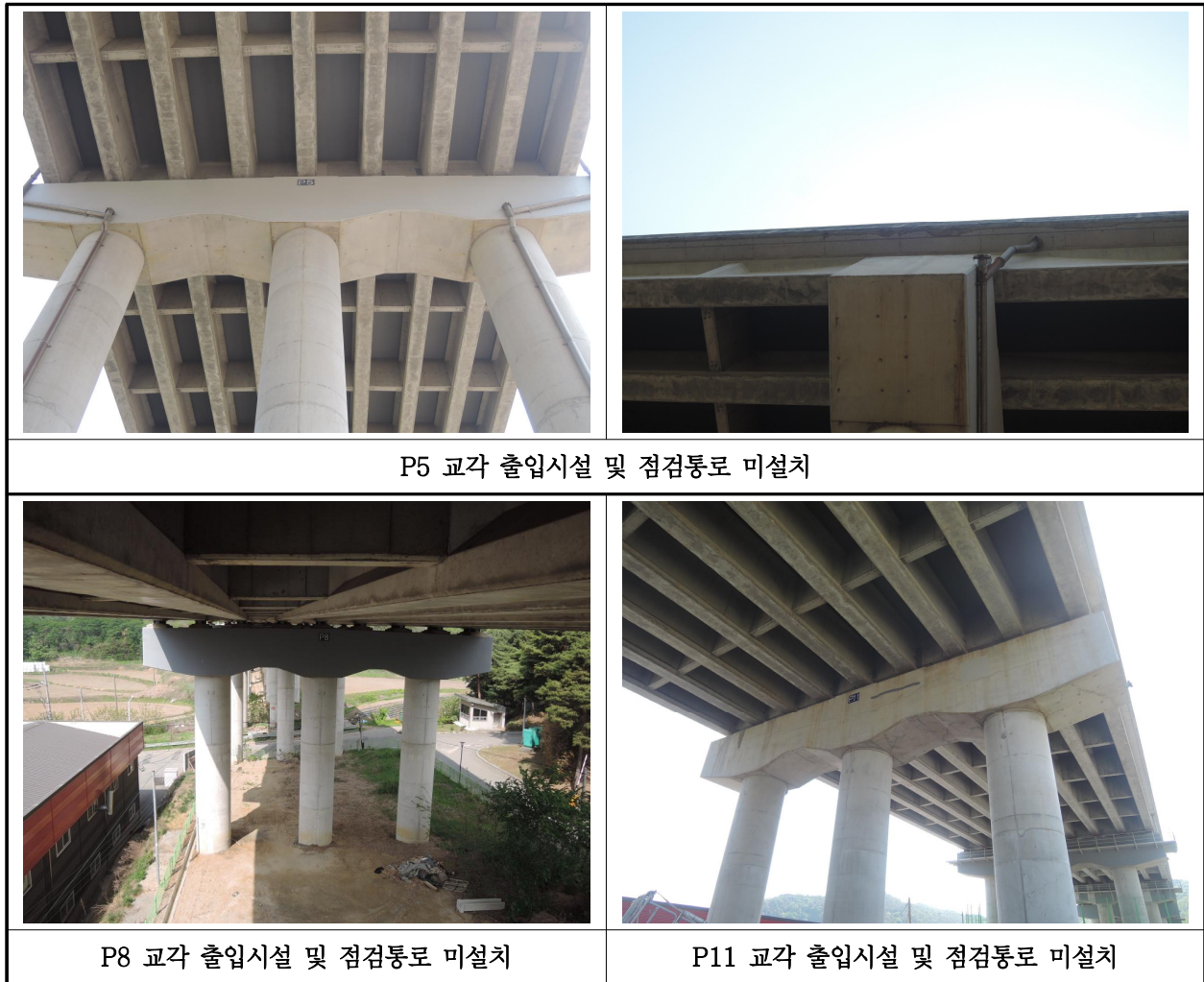
【사진 3.3.23】 교량 점검시설 손상현황
